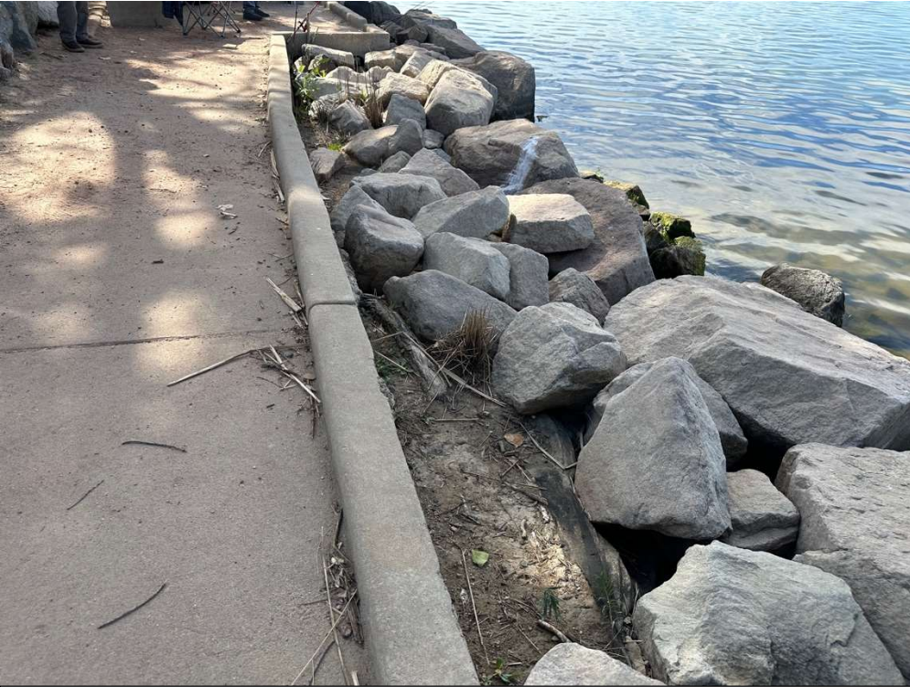
Trail edge erosion
